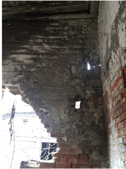
Fot. 24 Znaczne braki cegieł w ścianie zewnętrznej
