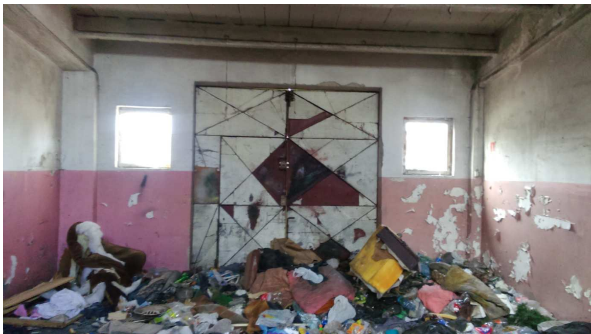
Fot. 32 Widok zdezastowanej bramy garażowej od wewnątrz
