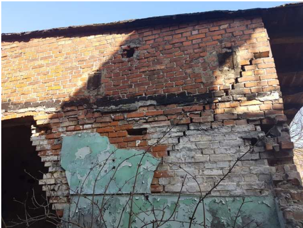
Fot. 22 Spękania na ścianie zewnętrznej obiektu II
