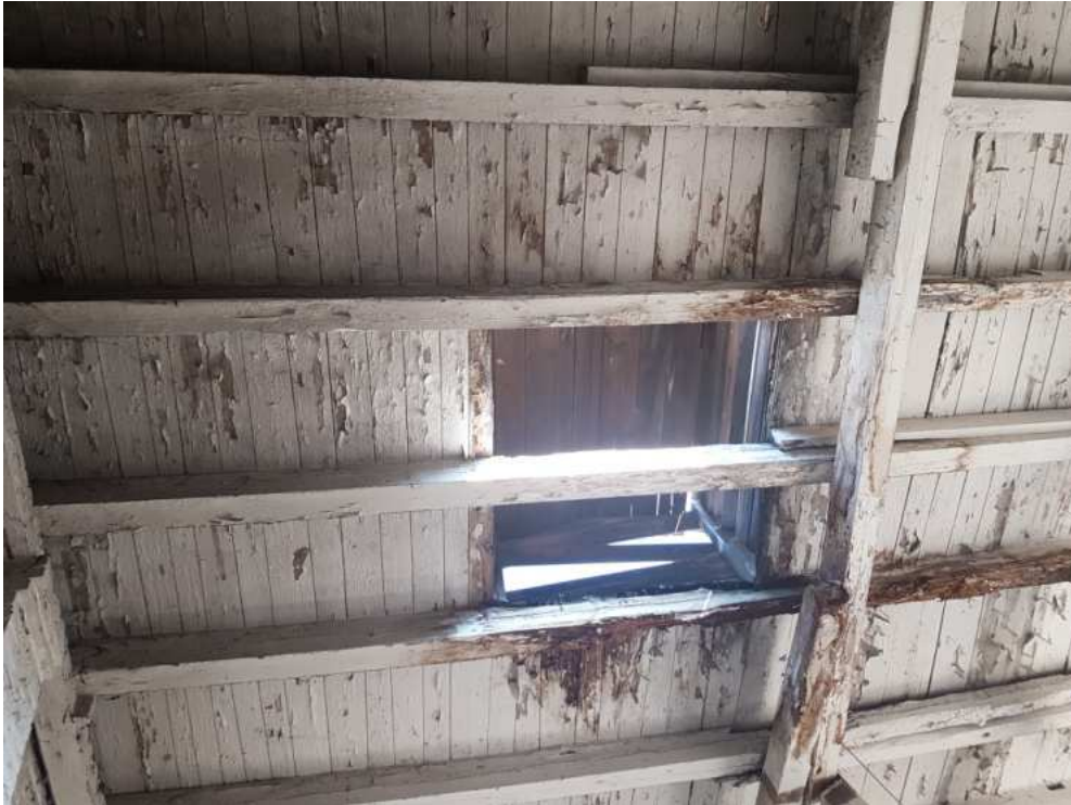
Fot. 28 Zniszczone belki konstrukcyjne dachu
