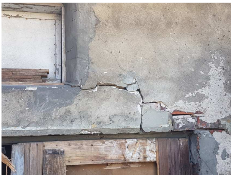
Fot. 37 Obiekt V - uszkodzone nadproże
