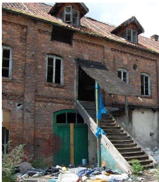
Fot. 18 Nieistniejące schody między przyziemem, a piętrem
