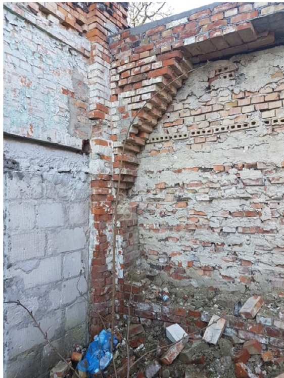
Fot. 11 Ubytki cegieł w murze
