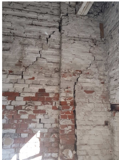
Fot. 25 Pęknięcia na ścianie wewnętrznej
