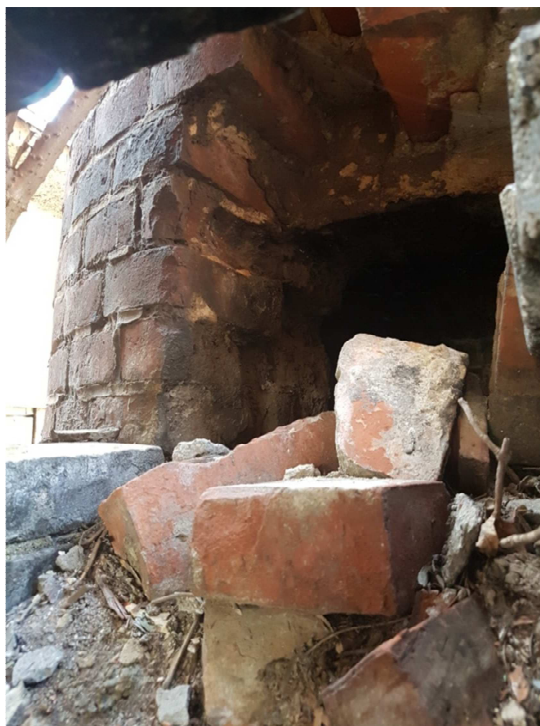
Fot. 33 Widoczne uszkodzenia ściany komina
