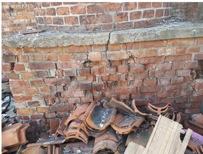
Fot. 34 Uszkodzenia podstawy komina murowanego
