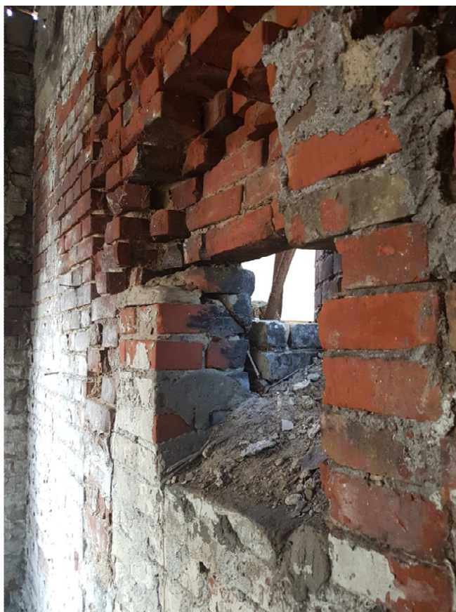
Fot. 14 Uszkodzenia ściany zewnętrznej
