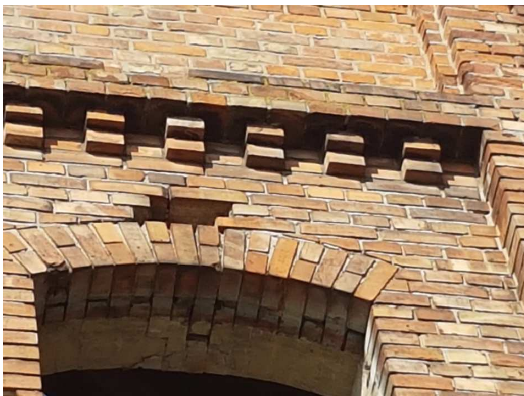
Fot. 15 Braki cegieł nad nadprożem okiennym
