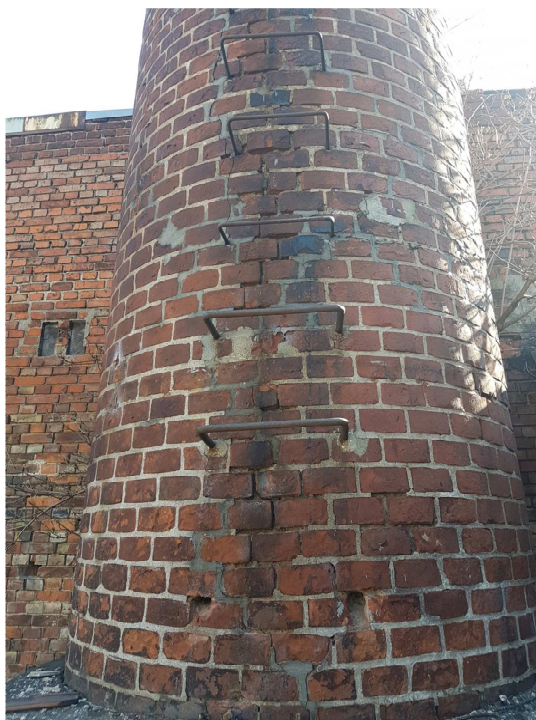
Fot. 4 Komin murowany
