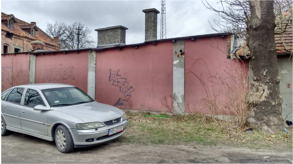
Fot. 9 Substandardowa dobudówka do budynku usługowego
