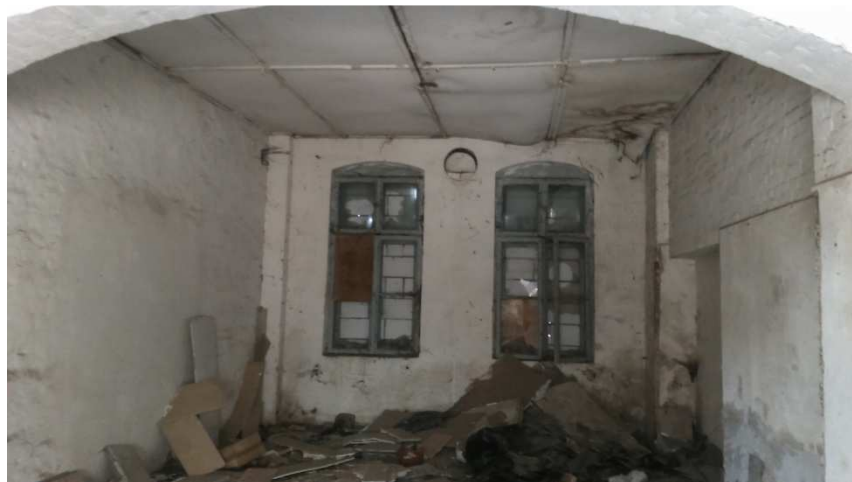
Fot. 17 W prawym górnym rogu widoczne efekty „zamakania” stropu wodą, dostającą się z nieszczelnego dachu
