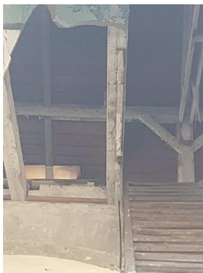
Fot. 19 Zniszczona klatka schodowa między piętrem a poddaszem
