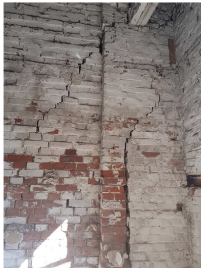
Fot. 25 Pęknięcia na ścianie wewnętrznej
