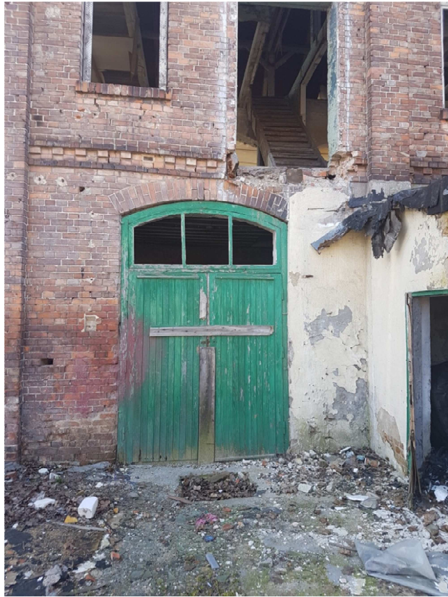
Fot. 10 Uszkodzenia muru obiektu I
