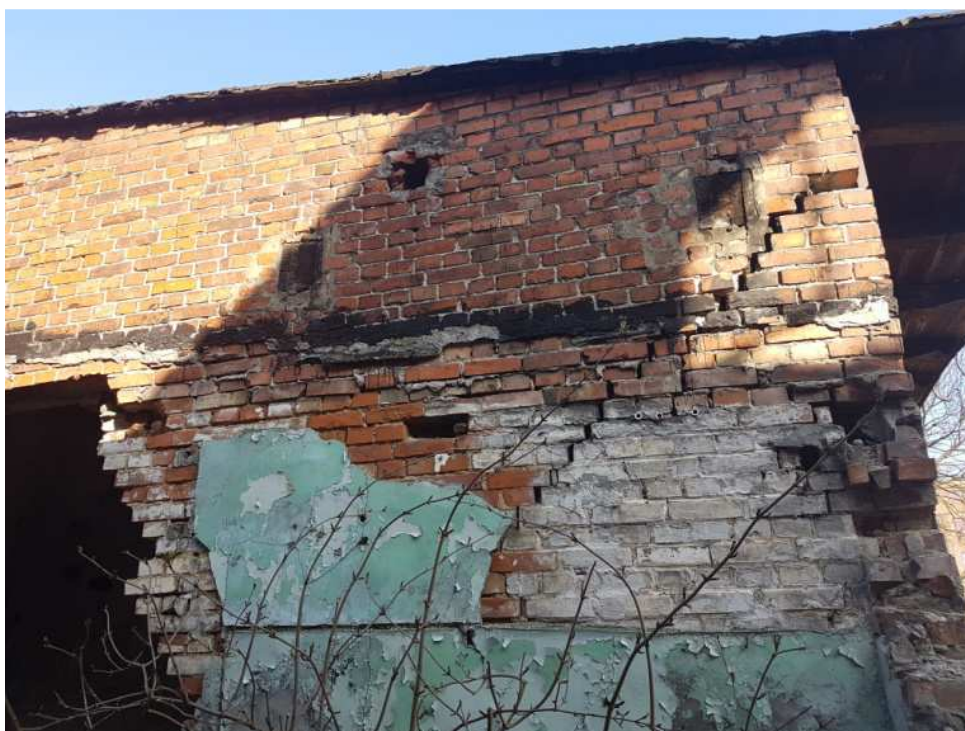
Fot. 22 Spękania na ścianie wewnętrznej obiektu II
