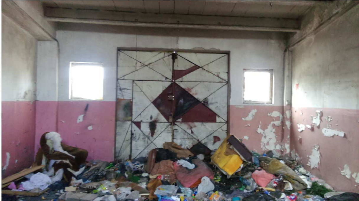
Fot. 32 Widok zrewastowanej bramy garażowej od wewnątrz
