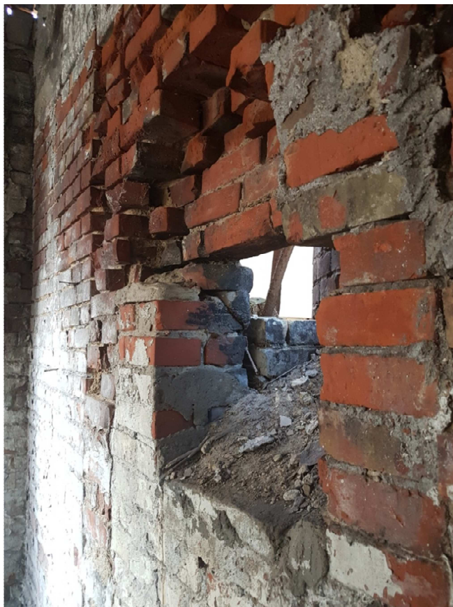
Fot. 14 Uszkodzenia ściany zewnętrznej
