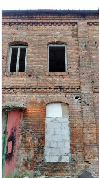
Fot. 16 Widoczne uszkodzenia muru
