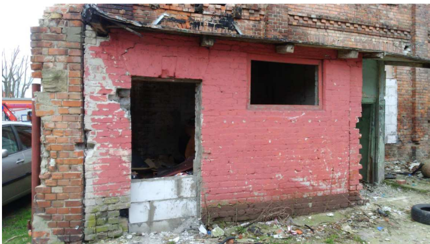
Fot. 35 Widoczne uszkodzenia muru, nadproża drzwiowego oraz pokrycia dachowego
