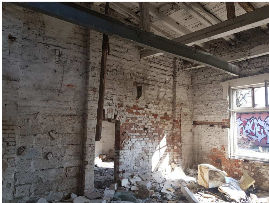
Fot. 29 Popękane drewniane elementy konstrukcji dachu
