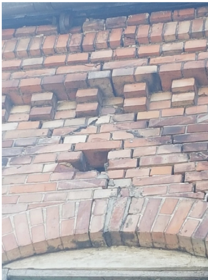
Fot. 13 Uszkodzenia nadproża okiennego
