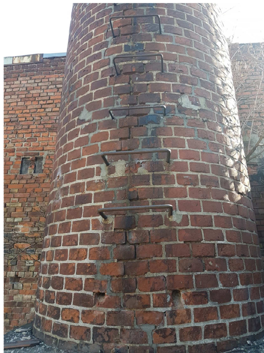
Fot. 4 Komin murowany
