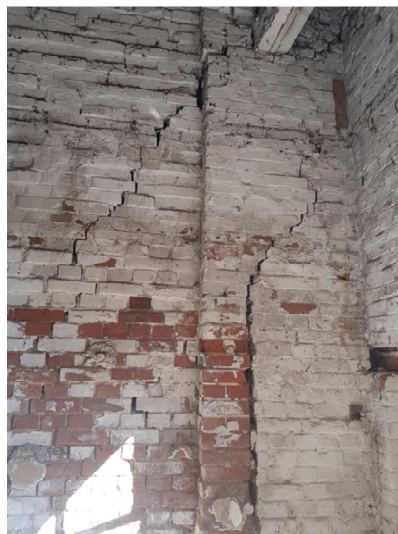
Fot. 26 Pęknięcia na ścianie wewnętrznej
