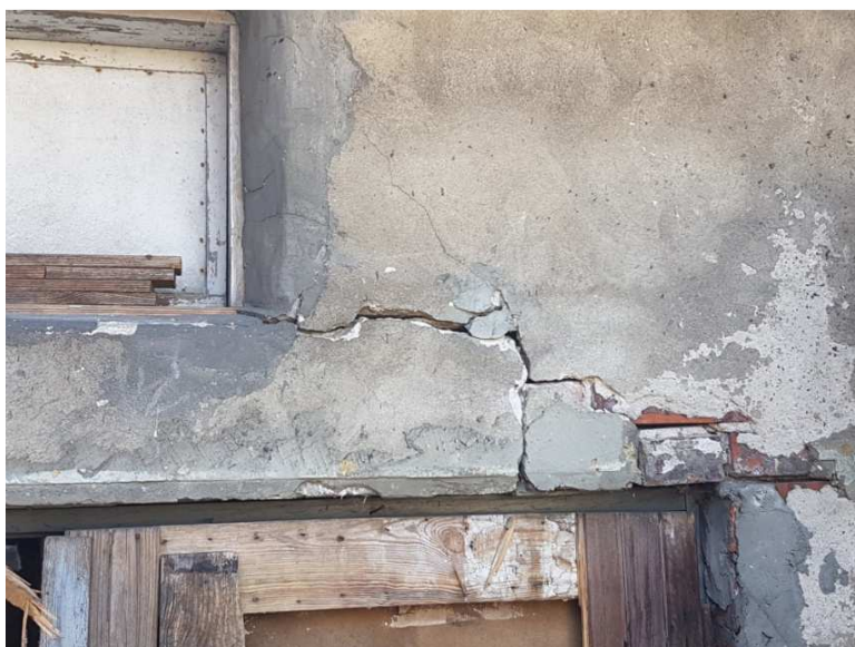
Fot. 37 Obiekt V - uszkodzone nadproże
