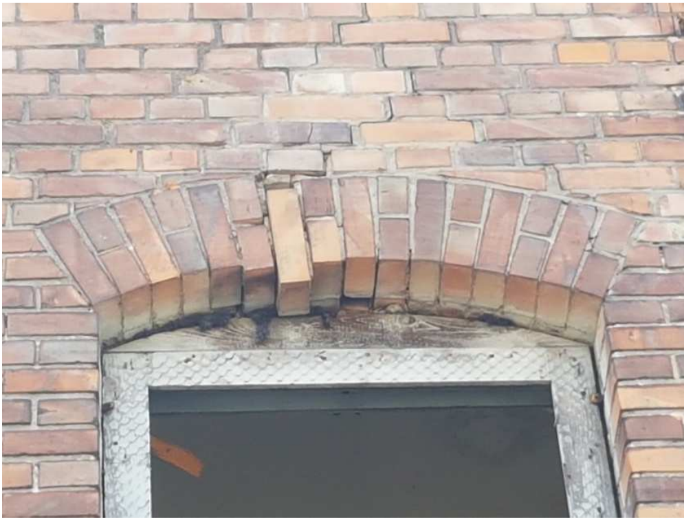
Fot. 12 Uszkodzenia nadproża okiennego
