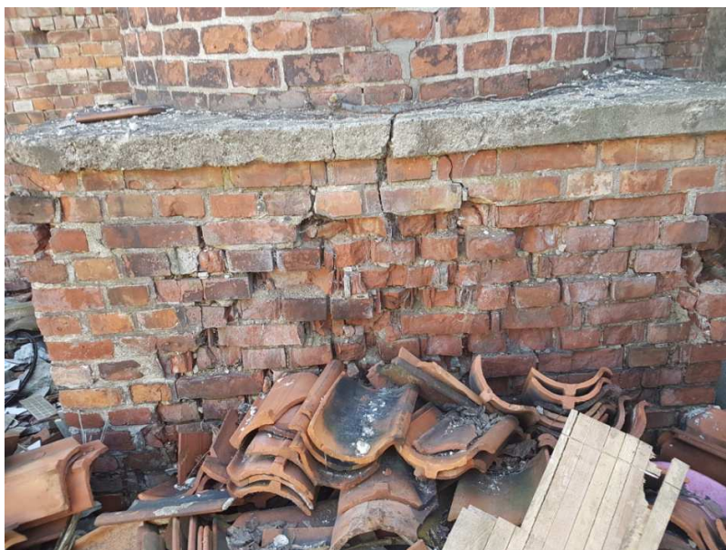
Fot. 34 Uszkodzenia podstawy komina murowanego
