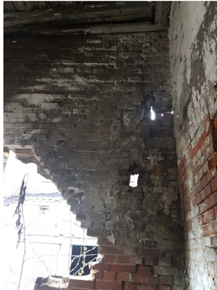
Fot. 24 Znaczące braki cegieł w ścianie wewnętrznej
