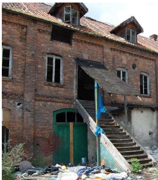
Fot. 18 Nieistniejące schody między przyziemiem, a piętrem
