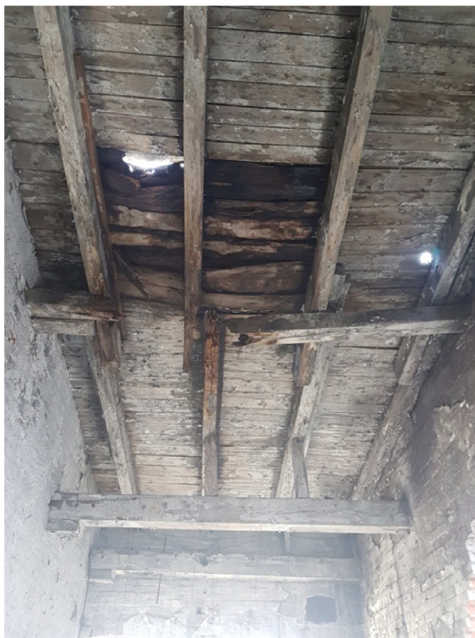
Fot. 27 Zniszczony dach – połamane krokwie i belka
