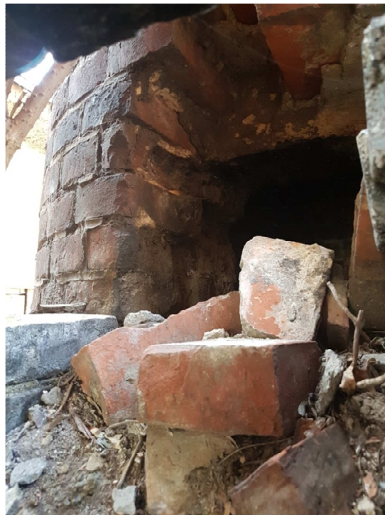
Fot. 33 Widok uszkodzenia ściany komina
